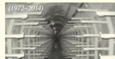
Kabelové tunely v Praze
